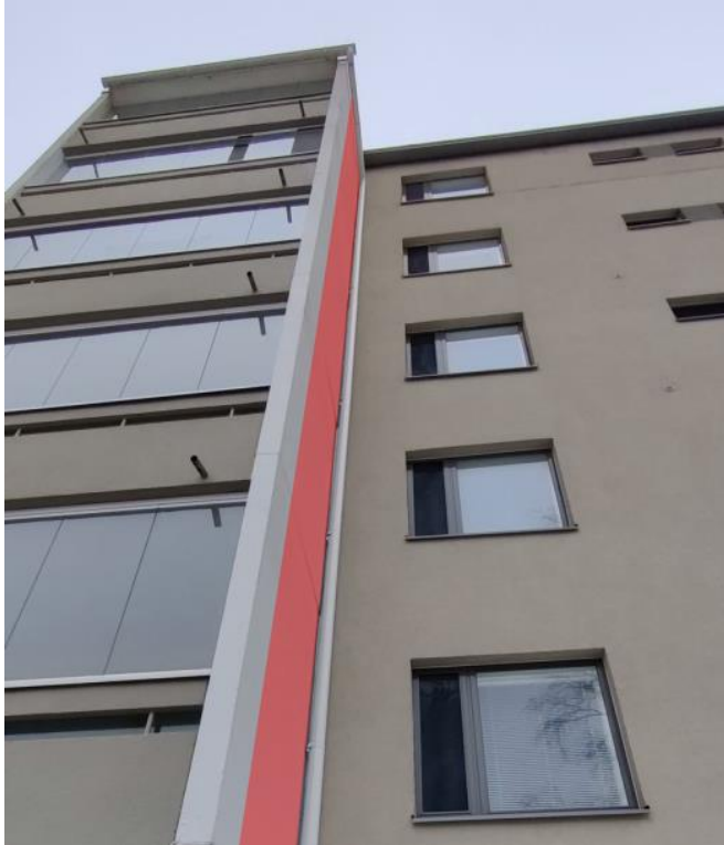
Kuva 8. Punaisella LTO-putket julkisivussa.
