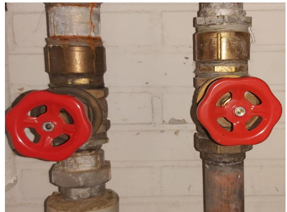
Kuva 8. Alkuperäisiä venttiileitä käyttövesiverkossa.
