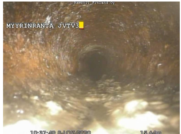
Kuva 15. Pohjaviemäreissä havaittiin korroosiota.
