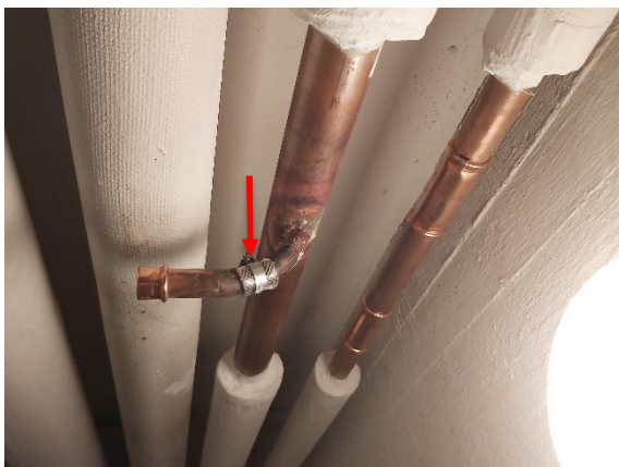
Kuva 9. Vuoto on korjattu väliaikaisesti kumipannalla ja putkiklemmarilla.
