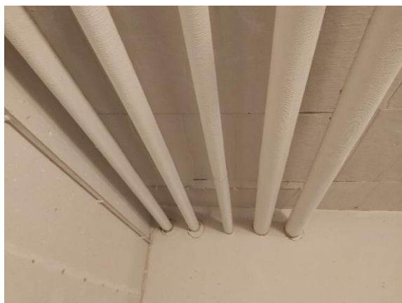
Kuva 11. Putkieristeet sisältävät todennäköisesti asbestia.
