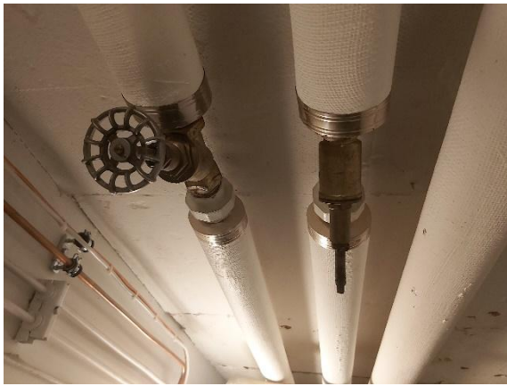
Kuva 1. Alkuperäisiä linjansäätö- ja sulkuventtiileitä.
