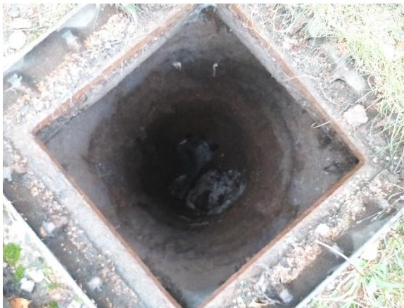
Kuva 14. Tarkastuskaivot ovat betonirengaskaivoja.
