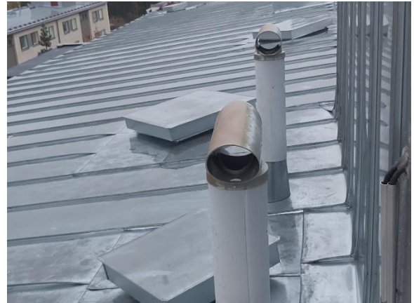
Kuva 13. Tuuletusviemärit on varustettu jäätymissuojilla.
