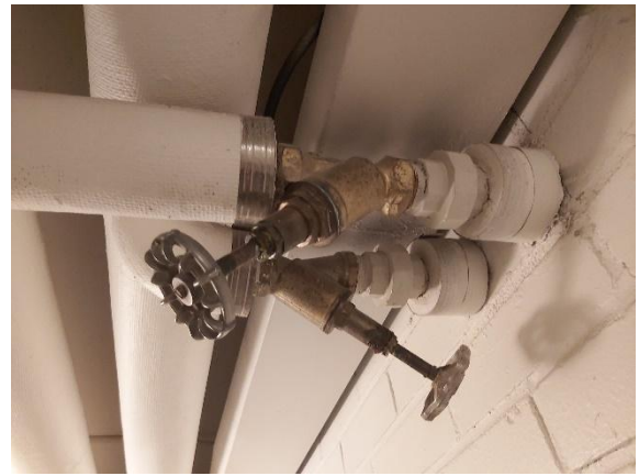
Kuva 2. Alkuperäisiä linjansäätö- ja sulkuventtiileitä.
