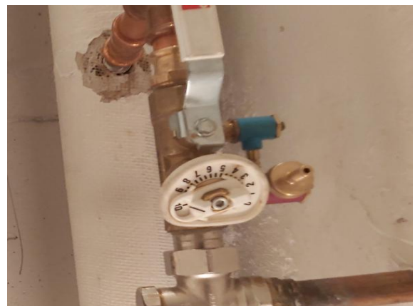
Kuva 10. Linjansäätöventtiili on täysin auki.
