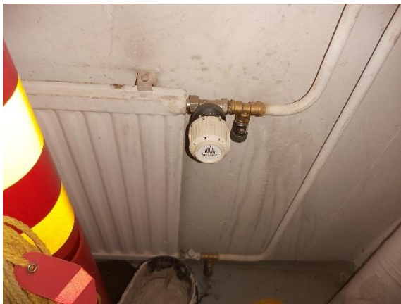
Kuva 3. Alkuperäinen teräslevypatteri sekä vuonna 1996 uusittu patteriventtiili.
