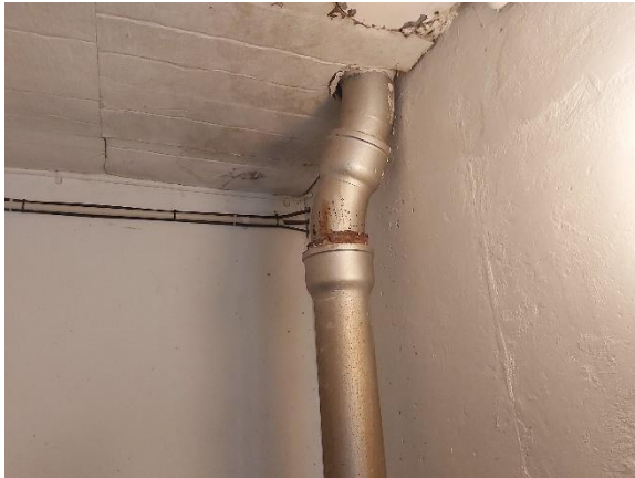
Kuva 12. Pohjakerrosten viemärit ovat valurautaa.
