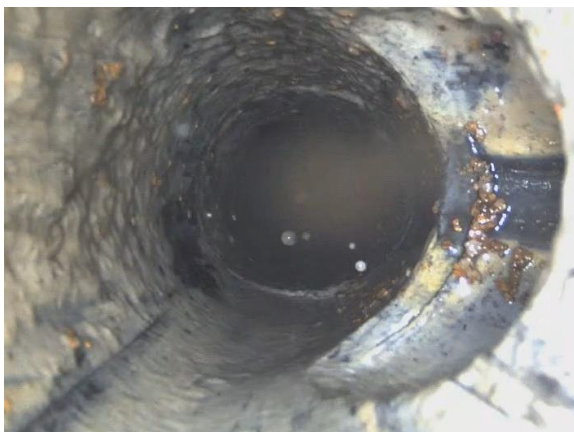
Kuva 16. Pystyviemäreissä havaittiin vähäistä kertymää.
